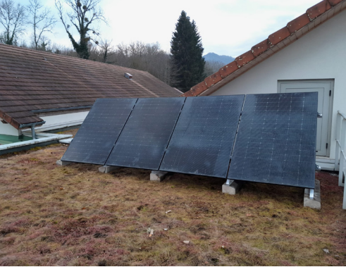
PPV sur le toit de l’école
